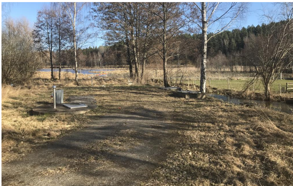
Befintlig pumpstation som säkerställs i och med planförslaget.
